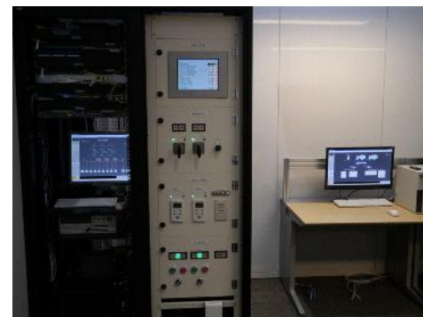
ビルプラント2
